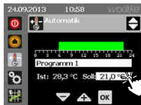
Abb. 14: Hauptmenü Heizen Automatik
