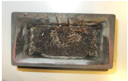
BEISPIEL VERSCHMUTZTE BRENNSCHALE
