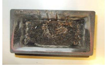
BEISPIEL VERSCHMUTZTE BRENNSCHALE
