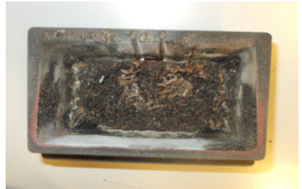
BEISPIEL VERSCHMUTZTE BRENNSCHALE
